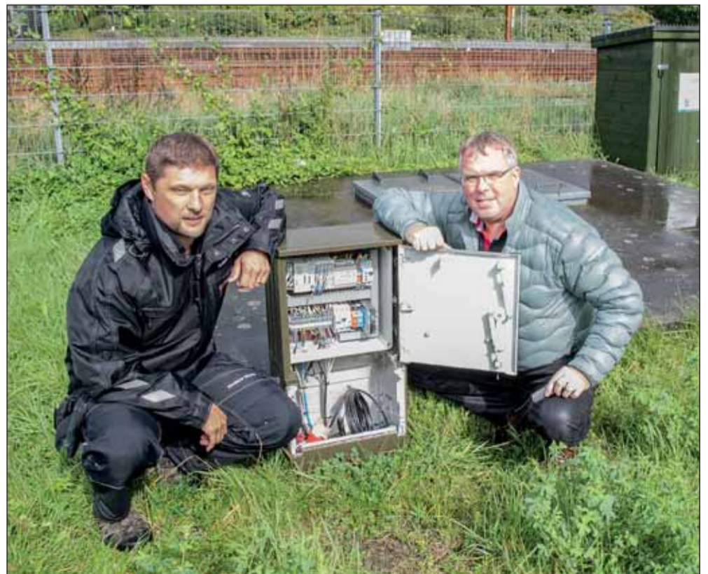
El-installatør Anders Werth, Werths El ApS, t.v., og produktchef Søren Luchau Jensen, WAGO Denmark A/S, t.h., ved et af styreskabene til et overløbsbygværk.
